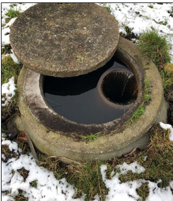
Figur 3-24 Brønd ved udløb fra sø.
